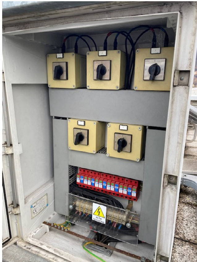
Quadro di sezionamento
