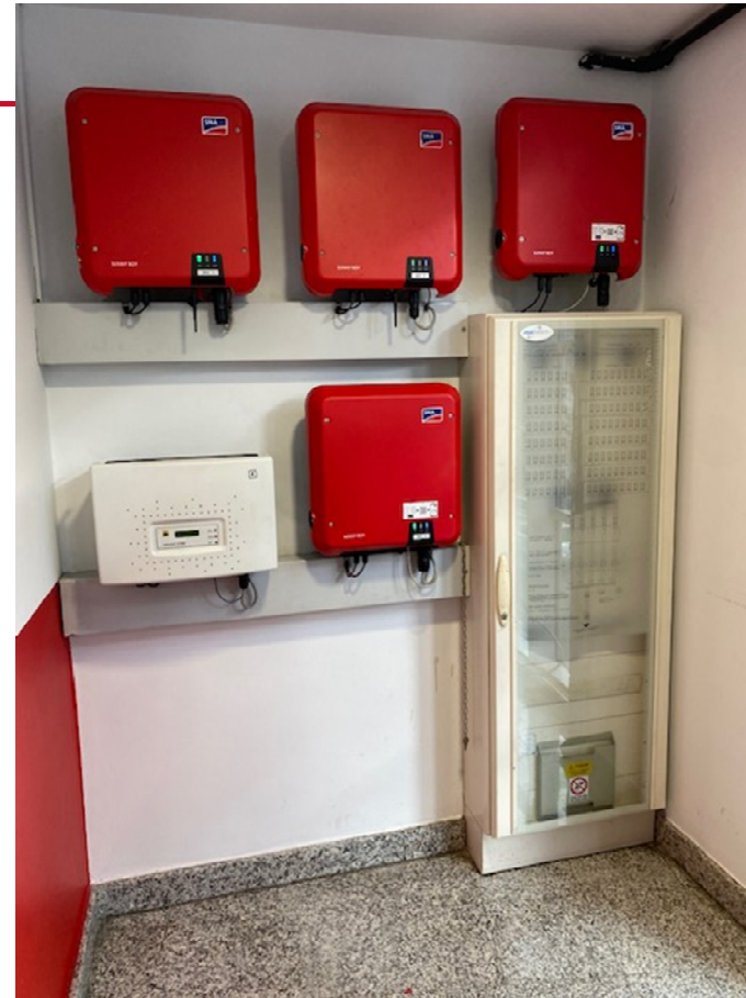
Convertitori statici DC/AC e Quadro di interfaccia
